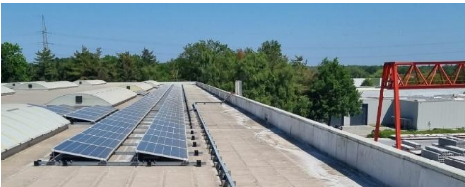
Die Photovoltaikanlage auf dem Dach von Fingo Malle 2
